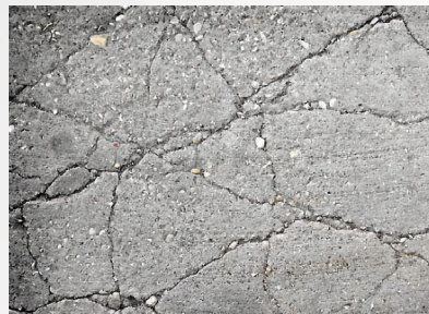
工程中遇到的裂缝
