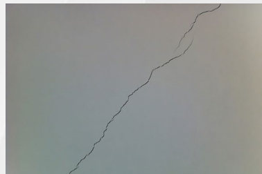
算法量化期望的裂缝
